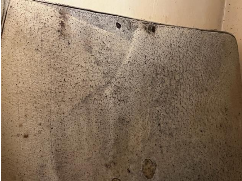
Un matelas, noir de moisissure, est appuyé contre un mur extérieur humide dans une chambre à coucher.
