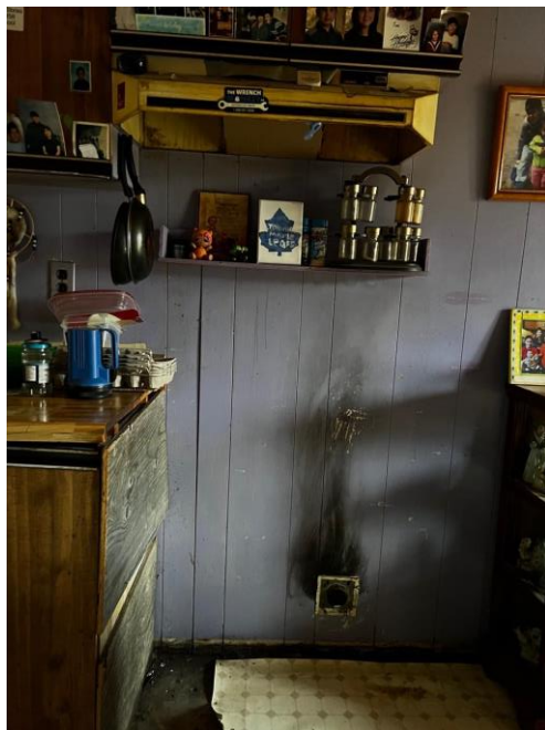
Maison privée d'électricité, d'eau et d'assainissement. Le câblage présente un risque d'incendie et un poêle a été enlevé.
