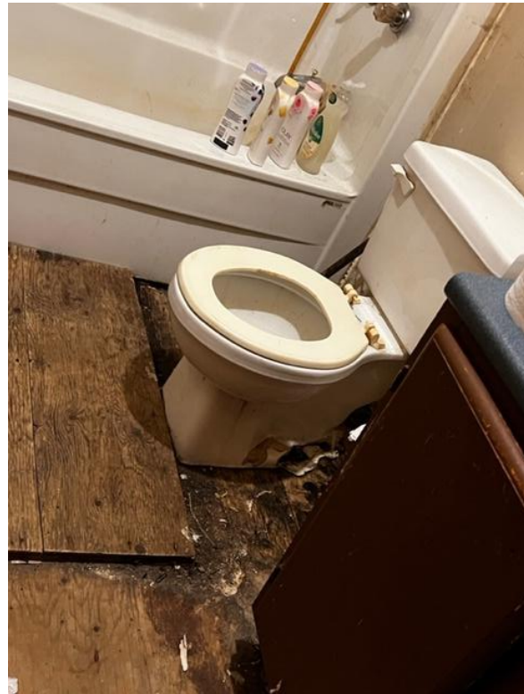
Des toilettes qui coulent entraînent de la condensation à l'extérieur de la cuvette, ce qui, avec le temps, compromet l'intégrité du sous-plancher autour des toilettes et crée de la moisissure.
