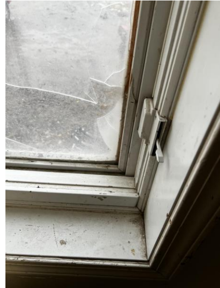
Quincaillerie de fenêtre de mauvaise qualité.
