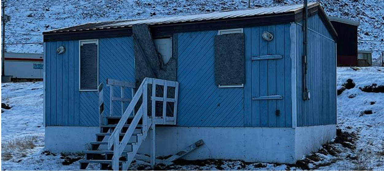
Une maison est barricadée et attend des réparations
