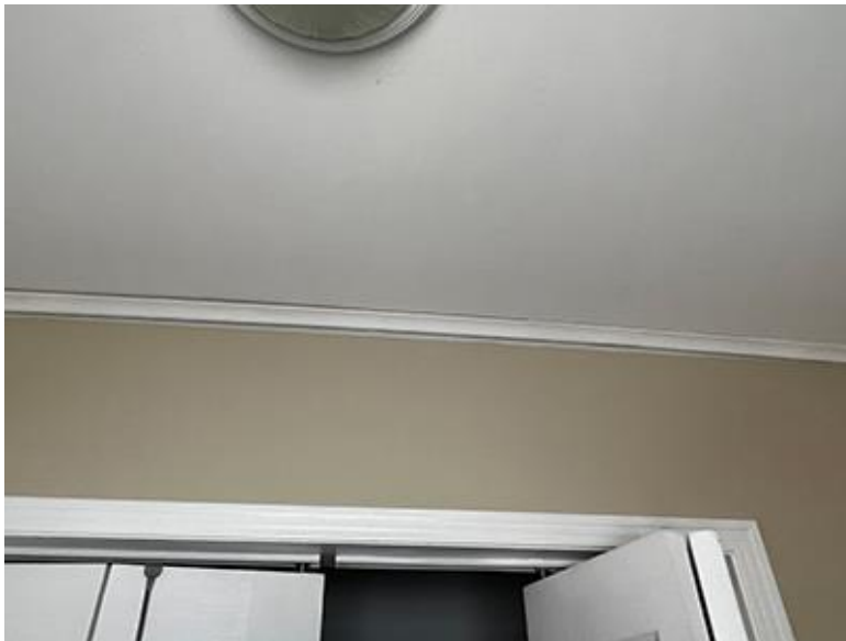
Dans une maison neuve, un espace commence à apparaître là où le plafond s'éloigne du mur.
