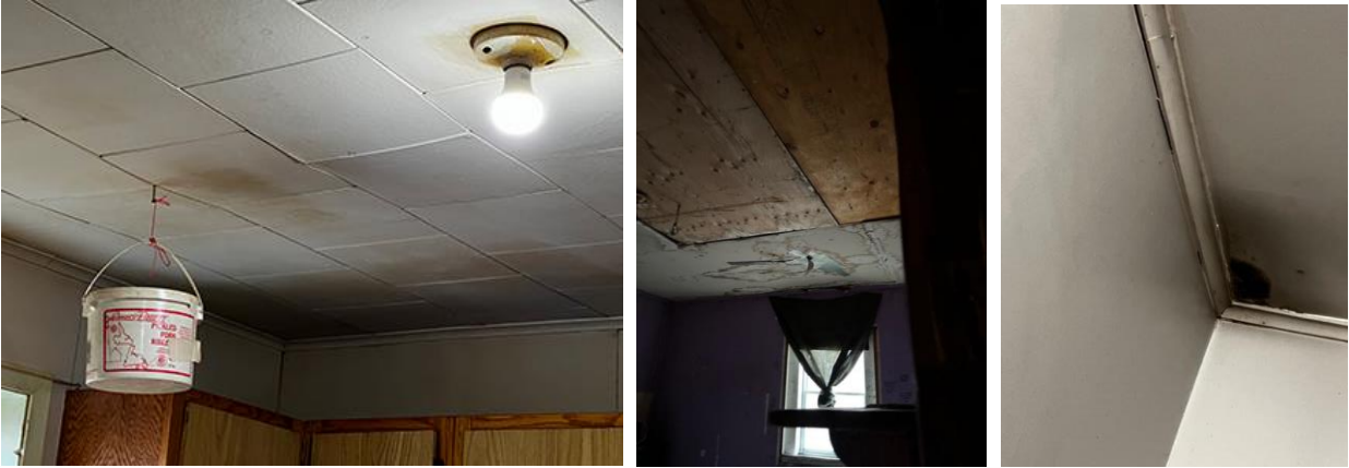
Des taches d'eau et probablement de la moisissure noire recouvrent les plafonds de plusieurs maisons.
