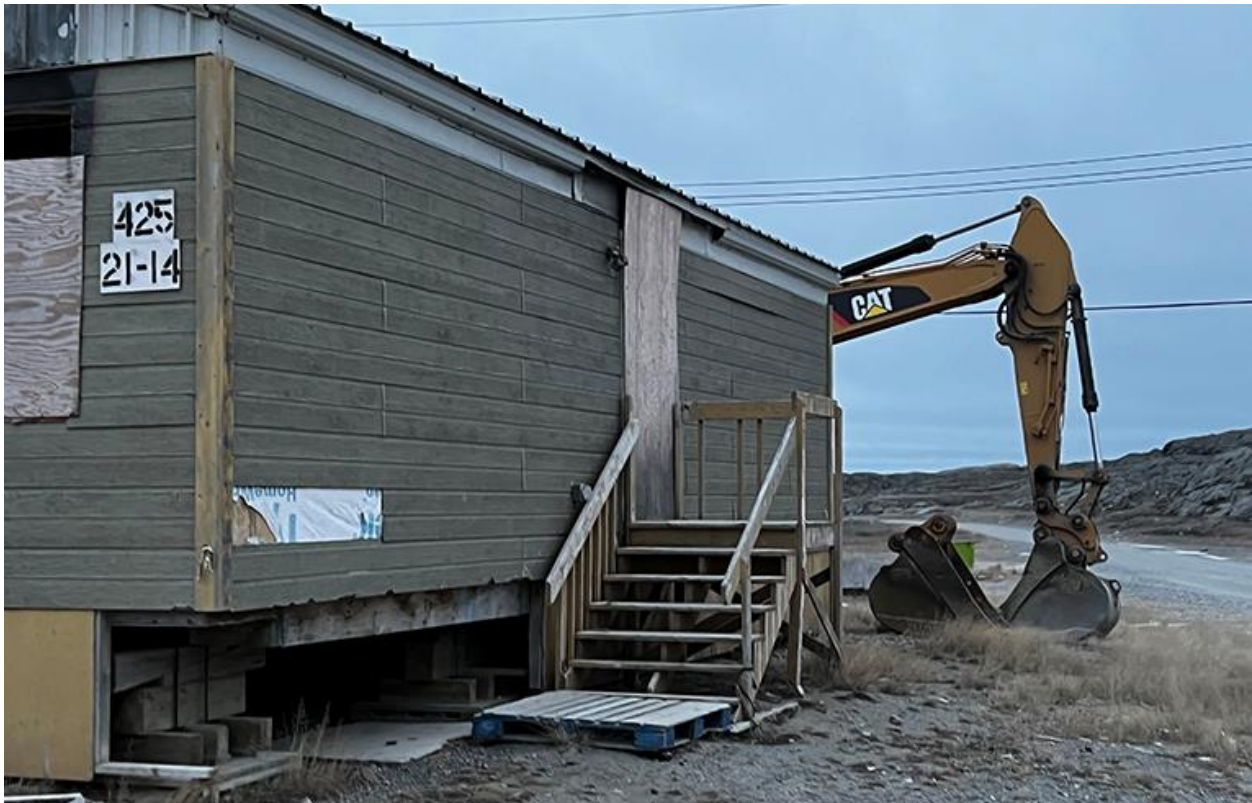
Maison ayant besoin de réparations à Rankin Inlet.
