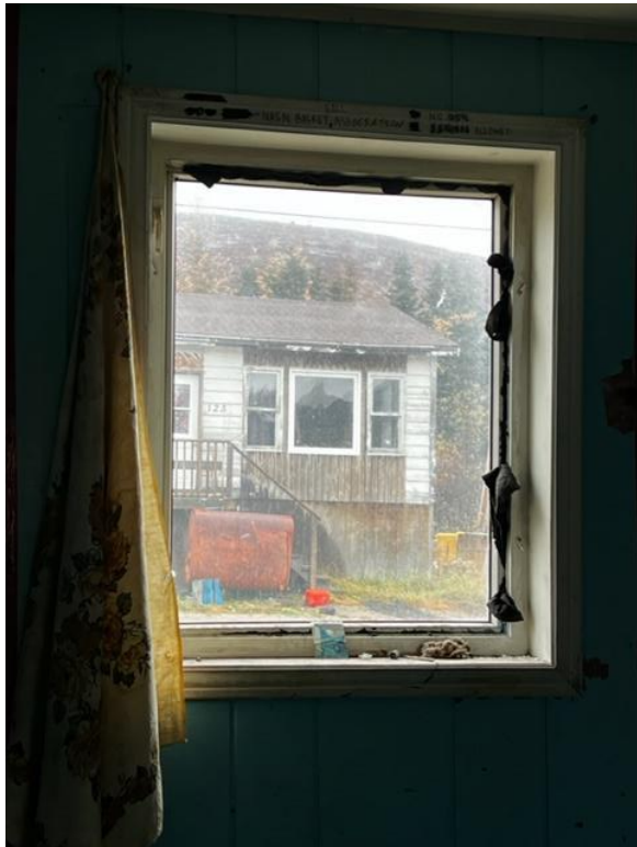
Fenêtres mal scellées.
